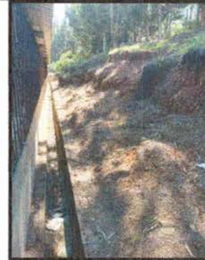
Foto 20: Es necesario ampliar muro de contención.
